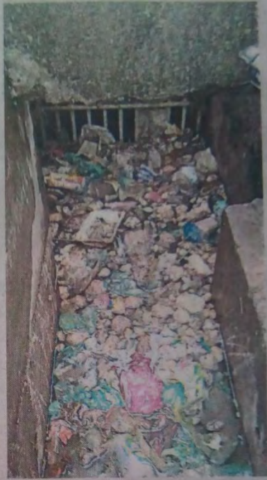
▲ 排水道垃圾闸处有大量垃圾。
